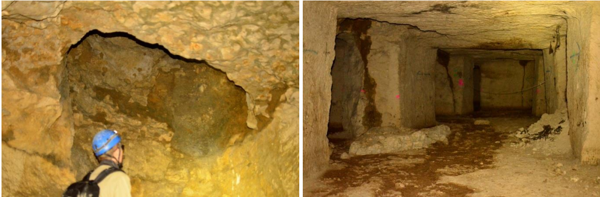
Illustration 11 : A gauche, amorce de cloche de fontis lié à un déboufrage karstique, et à droite, développement d'un drain karstique calé sur une fracture naturelle (diacalse). Notons également la chute de toit associée à cette fracture karstifiée
