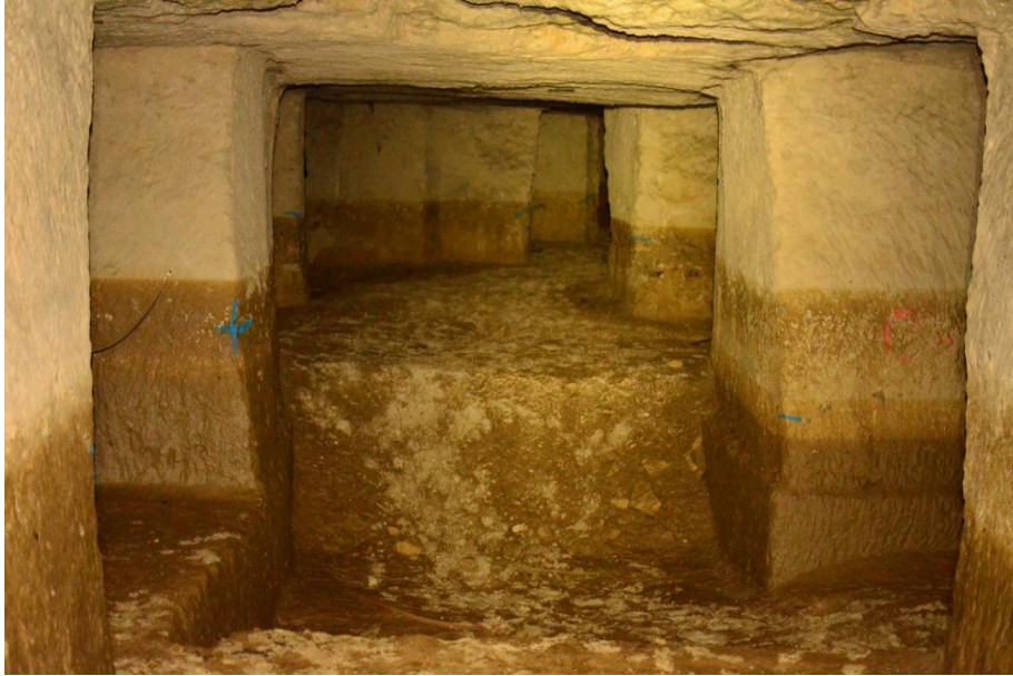
Illustration 5 : Traces et dépôts de limons bruns ocre encore humides sur les parois et le sol de la carrière, témoins d'inondations plus ou moins anciennes
