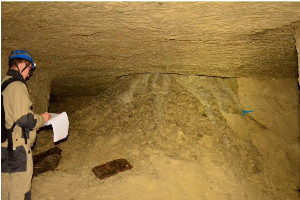
Illustration 10 : Cône d'éboulis lié à la remontée d'une cloche de fontis, localisé sous la route départementale n°8
